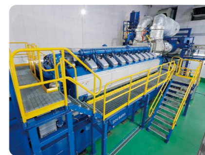
天然ガスコージェネレーション設備 内観
