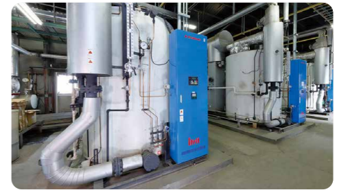
高効率ボイラー
