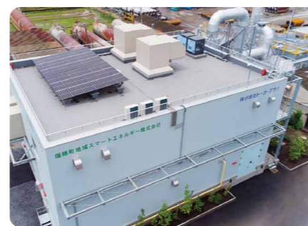
天然ガスコージェネレーション設備 外観
