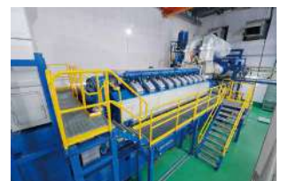
天然ガスコージェネレーション設備 内観
